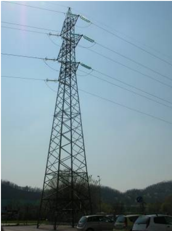
Figura 6 - Elettrodotto Linea Terna 132 kV Gorlago-Seriate
