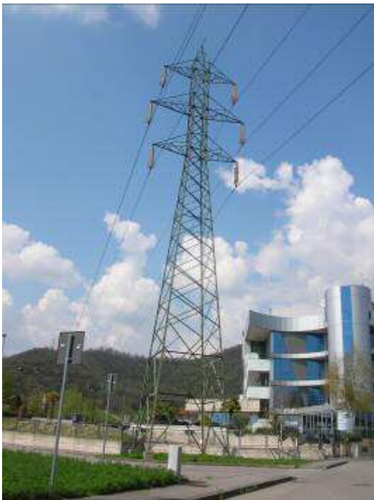
Figura 7 - Elettrodotto Linea Italgas 130 kV Villa di Serio Rezzato
