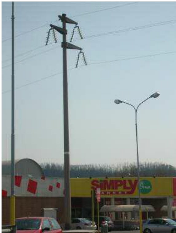
Figura 8 - Elettrodotto Linea Italgas 45 kV Villa di Serio Palazzolo S/O
