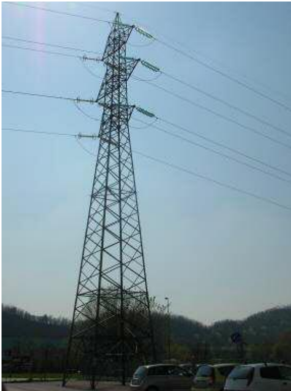
Figura 6 - Elettrodotto Linea Terna 132 kV Gorlago-Seriate
